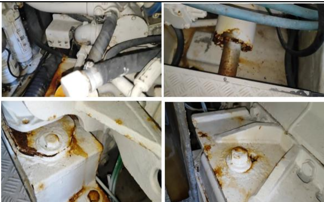
FIGURA 10: pontos de oxidação notáveis nos motores e eixo de propulsão
