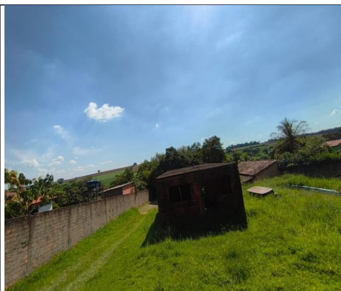
Lote de terreno sob número 3 da quadra G do loteamento São Francisco, Edificações em ruínas. Vista interna do lote.
